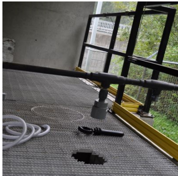
FE 505- Effluent Flow Ultrasonic
